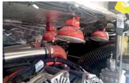
کپسول های اطفاء حریق تیپ ۱
