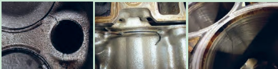
شکل ۶۲. ترک در سیلندر و بلوکه سیلندر
